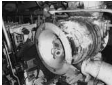
破壊された主機
